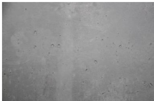
(b) 涂刷色拉油脱模后混凝土表面
