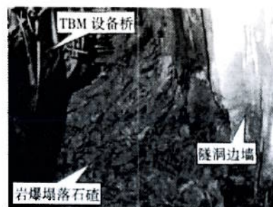
图 1 TBM 施工隧洞岩爆图片
