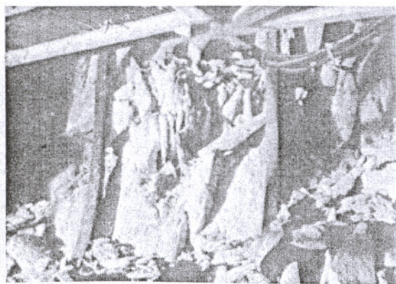
图 2 爆坑附近边墙下部破坏情况
