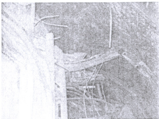
图 3 右侧拱顶位置塌方情况
