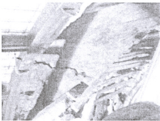
图6 SK14+230~SK14+222段岩爆塌方产生的塌腔
