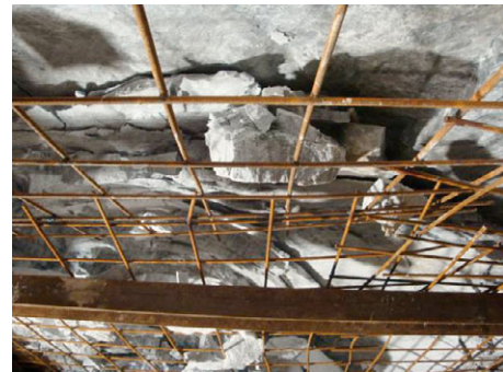
图1 排水洞洞壁板裂化岩爆现象
